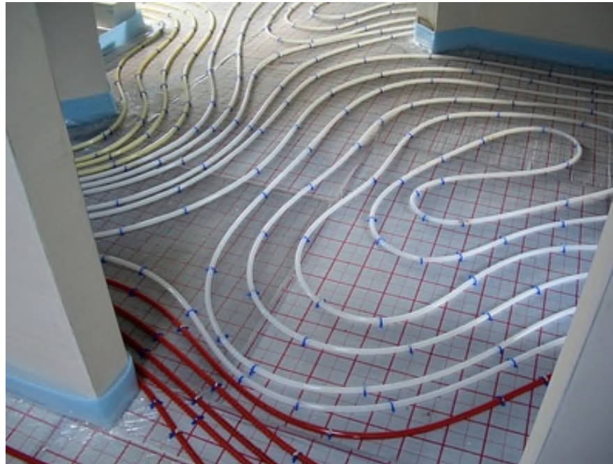
Schläuche einer modernen Bodenheizung, welche unter dem Boden verlegt werden.
